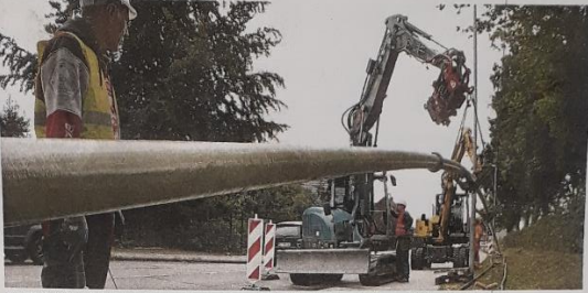
Das 160 Meter lange Gasrohr wurde aus Einzelstücken zusammengeschweißt und mit einem Glasfaser- und Plastikschutz ummantelt.
